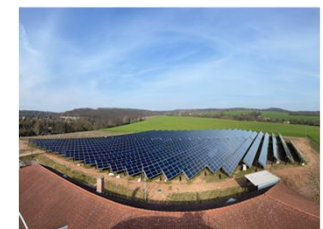
Stadtwerke Sonderhausen (DE)
