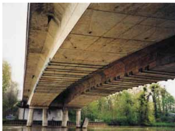
Figure 10 - Précontrainte transversale additionnelle (Photo : Sétra)
