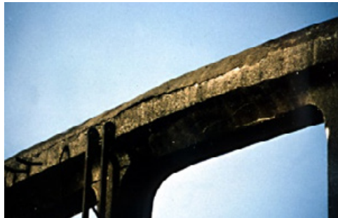
Décollement d'un enduit
