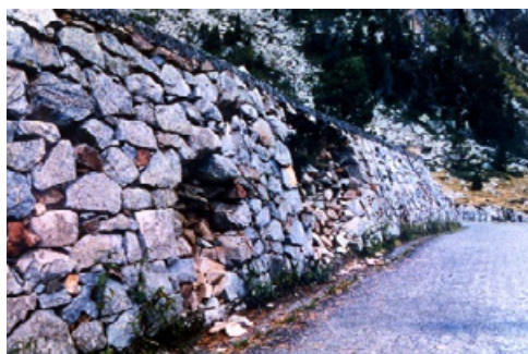
Effondrement partiel d'un mur en maçonnerie
