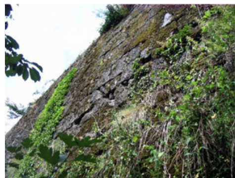
Bombement de maçonnerie avec disjointement
