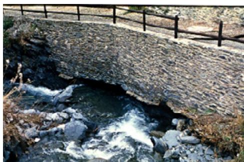
Affouillement avec altération de la fondation
