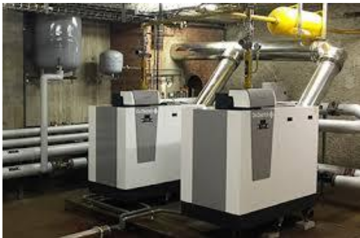
Chaudière à combustible (gaz, fioul, bois)
