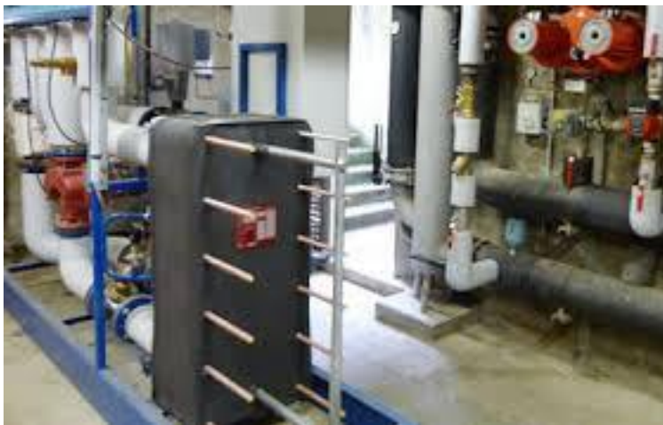
Sous-station avec échangeur
