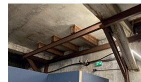
HALLE Au droit du Laboratoire, les infiltrations d'eau ont endommagé le plancher et les poutres
