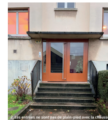
2. Les entrées ne sont pas de plain-pied avec la chaussée
