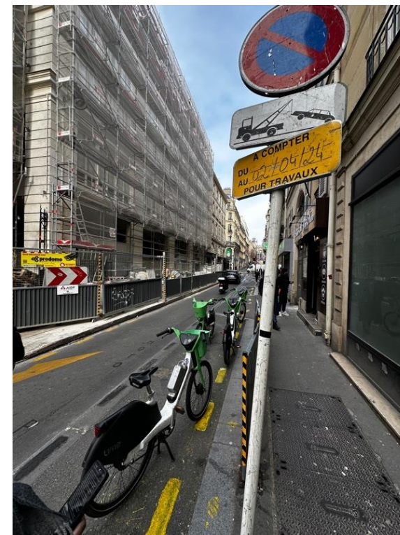
Des places de stationnement neutralisées pour travaux sur le terrain, mais toujours référencées sur Paris data et... sur les applications de vélos en libre-service
