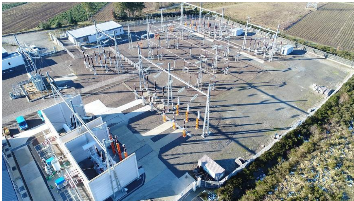
Vue d'un poste source électrique (Enedis)
